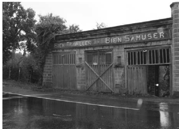
Le portique de Fauquez dans un état dangereux
